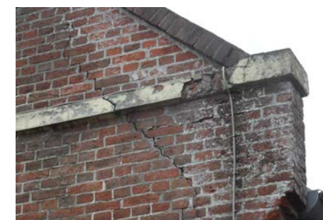
Scheur in muur
