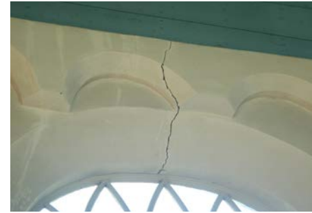
Scheur in muur
