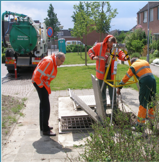
gemaal Puttershof Heinkenszand
